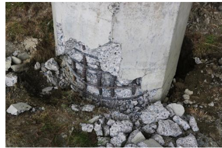
(d) Plastic hinge and spalling - Wandle River
