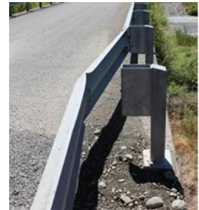
(d) Lottery River Bridge – deck offset
