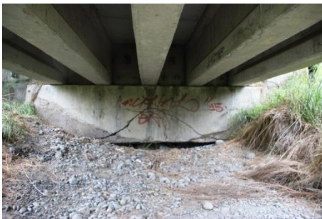
(d) Cracks and rotation on the western abutment
